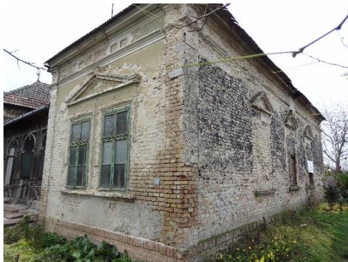
17. kép: A védelemre érdemes kúriák közül talán a legkisebb a Bóday kúria ugyan elég leromlott állapotban van, de a még meglévő homlokzati elemek alapján jól rekonstruálható. A helyszíneléskor kapott információ szerint folyamatban van a bérbeadás megszüntetése. Tulajdonosa az állam, remélhető egy igényes rekonstrukció.
